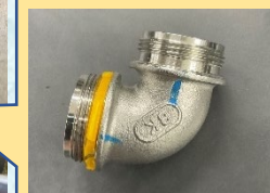
抜け落ちた配管の接続部
