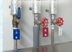
給湯機の配管が破損
