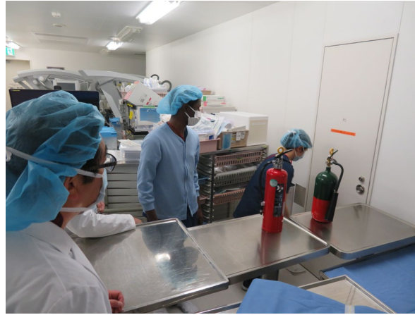
手術室のCO2消火器
