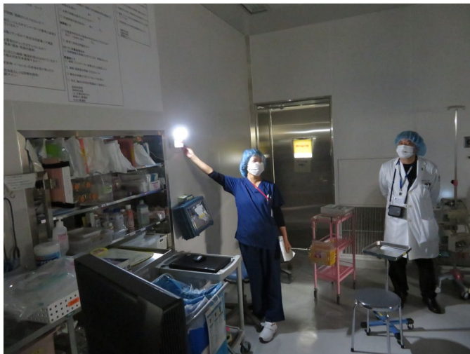
手術室カ二電源の機能確認
